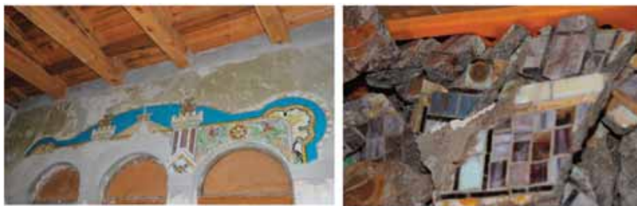
Ilustracja nr 22. Fizyczna rekonstrukcja fragmentów mozaiki szklanej. Z lewej: uszkodzony fresk ścienny w kaplicy; z prawej: odnalezione fragmenty
